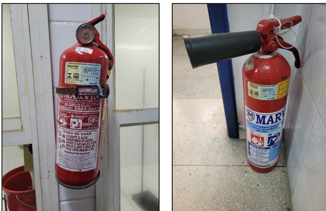
Figura 2 – Extintores posicionados junto à capela (imagem da esquerda) e junto à saída do laboratório (imagem à direita)
