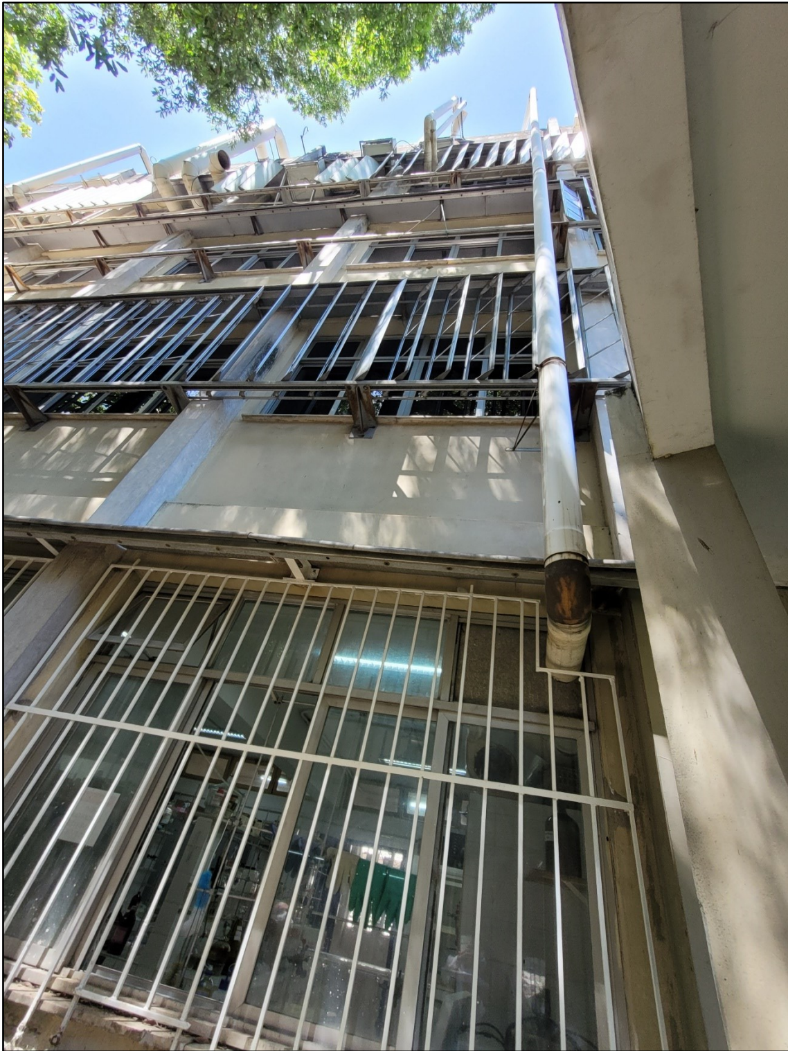
Figura 5 – Tubulação externa da exaustão das capelas para saída no telhado.
