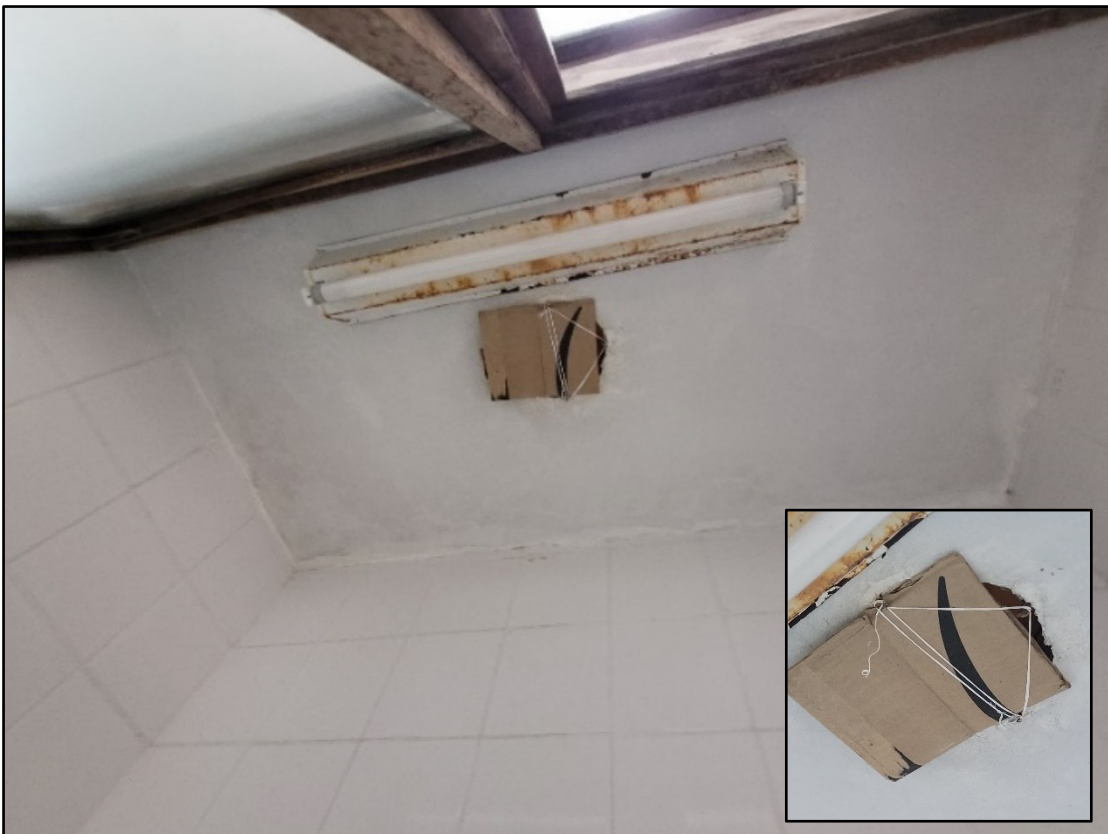
Figura 4 - Capela sem exaustão ligada em série às restantes: ocupada com materiais (cimo, à esquerda), remendo com fita durex no tubo de saída da exaustão (cimo, à direita); e remendo com cartão na saída da exaustão no teto da capela (imagem em baixo, com detalhe no canto inferior direito).
